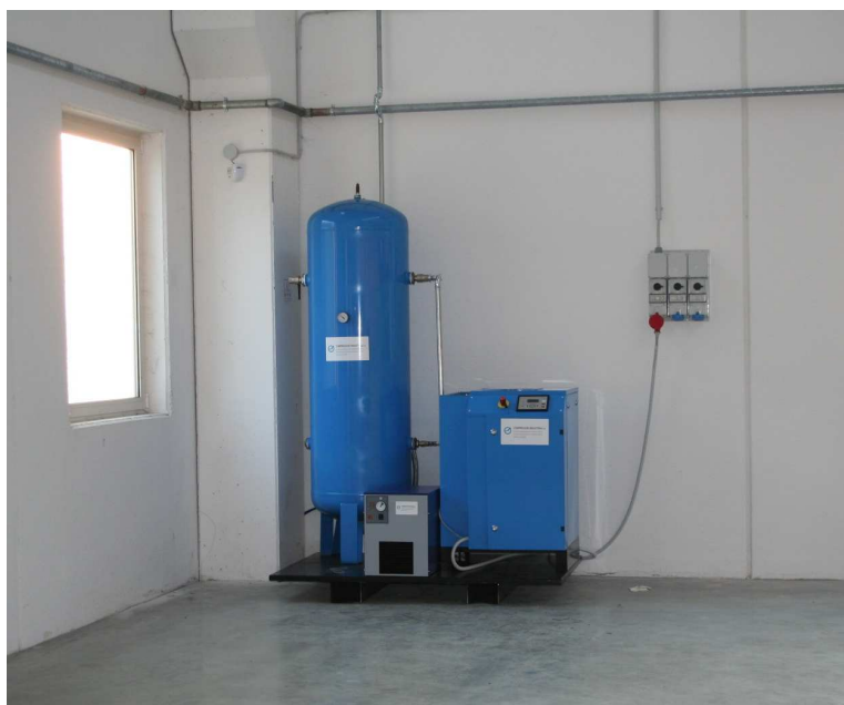
Installazione SKID 10 – vista frontale e profilo
